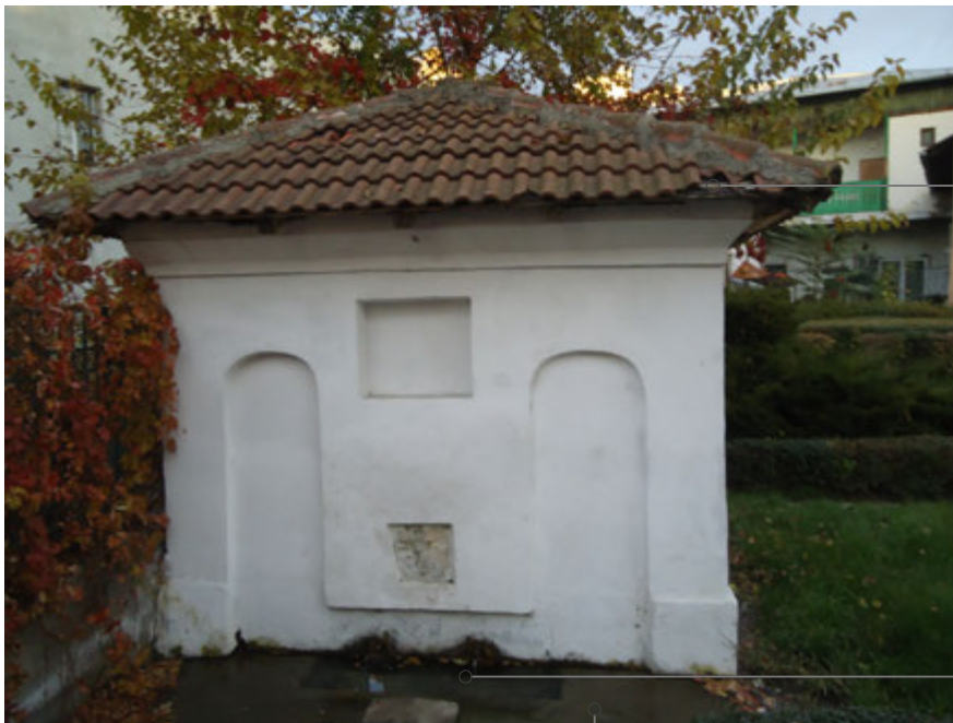
INVELITOARE CERAMICA - OLANE -elemente lipsa; -elemente deteriorate
